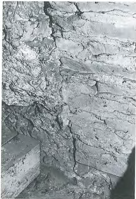
Abb. 27 Der Schalungsmörtel des eingezogenen Bogens zieht an die Abbruchreste der Mauerkrone des Treppenhauses an. Vgl. Abb. 28, Wand 2c, Pfeil.
